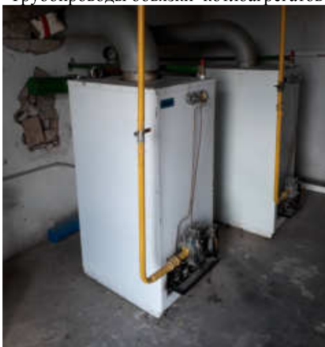
Видимое изображение №3 Трубопроводы обвязки котлоагрегатов
