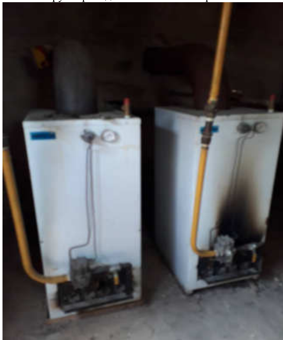
Видимое изображение №2 Трубопроводы обвязки котлоагрегатов
