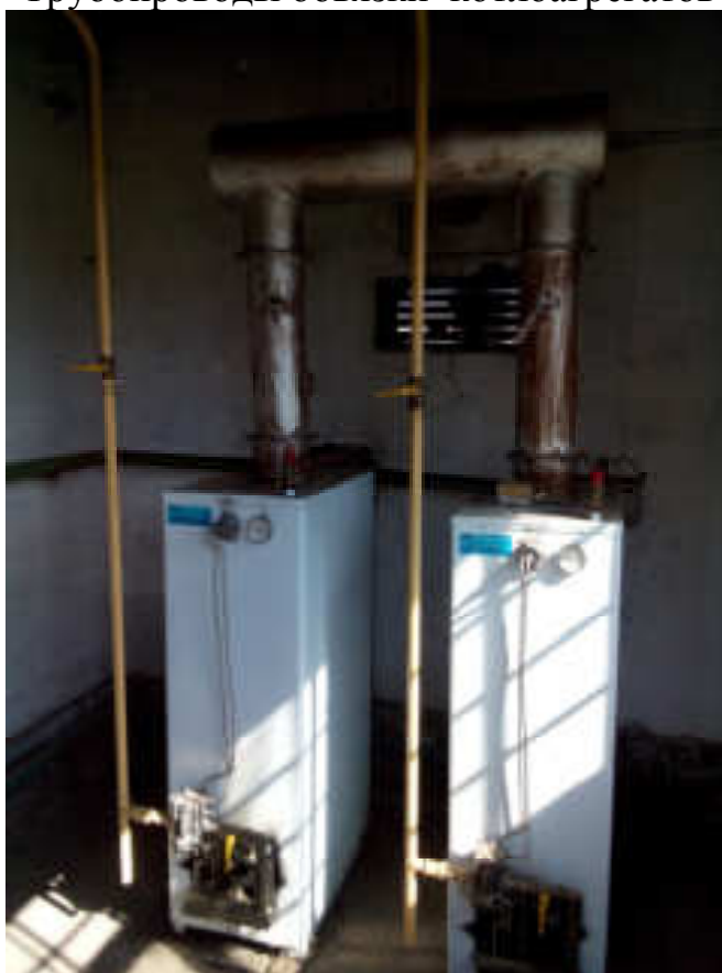
Видимое изображение №3 Трубопроводы обвязки котлоагрегатов
